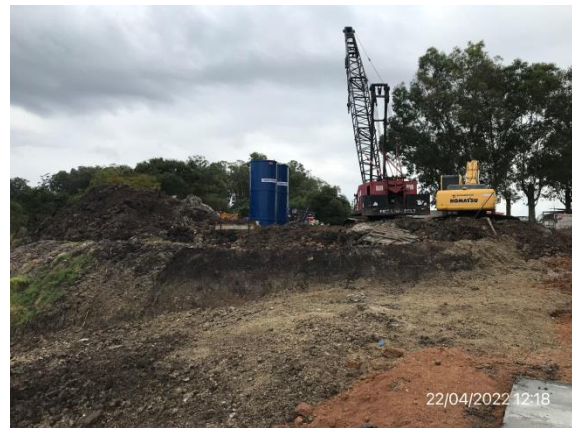
Ilustración 13 – P03, Obrador de Costa Fortuna SA. No cuenta con infraestructura para la gestión de residuos.
