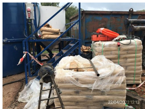
Ilustración 15 – P03, Obrador de Costa Fortuna SA. Depósito de insumos.
