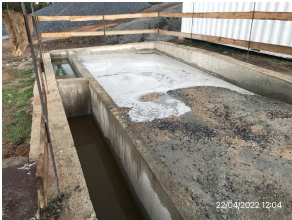
Ilustración 6 – P03, Planta de hormigón de Molinsur SA. Explanada de lavado de camiones mixer con pileta de decantación de sólidos
