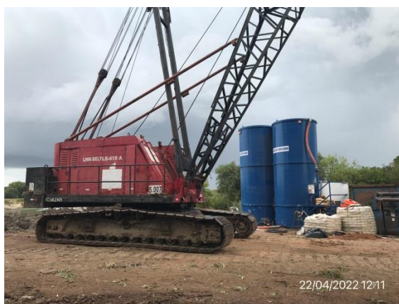
Ilustración 14 – P03, Obrador de Costa Fortuna SA. Depósitos de bentonita.
