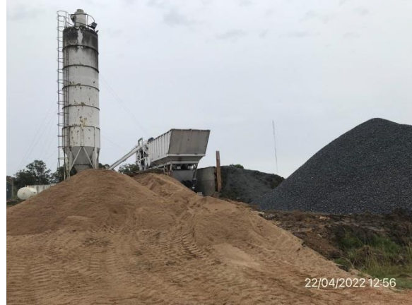
Ilustración 5 – P03, Planta de hormigón de Molinsur SA. Acopios de piedra partida y arena utilizados en planta de hormigón
