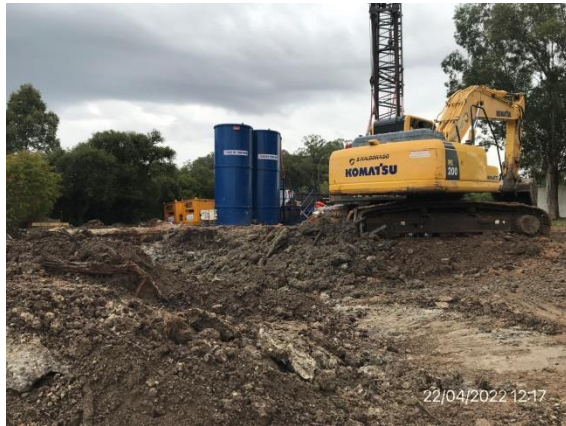
Ilustración 16 – P01, Cabecera Oeste del nuevo puente. Frente de Obra, pilotaje en tierra por parte de subcontratista Costa Fortuna SA.
