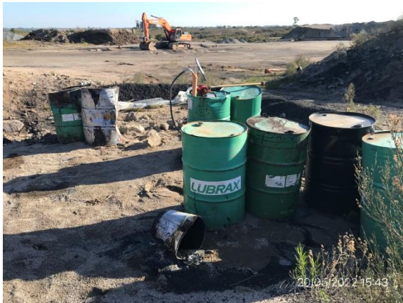
Ilustración 12 – P03, Obrador con actividad mínima. Tarrinas de emulsión asfáltica sin contenciones para prevención de derrames
