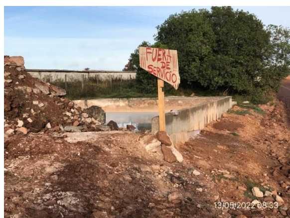
Ilustración 15 – P05, Obrador secundario. Pileta de lavado de camiones mixer fuera de servicio
