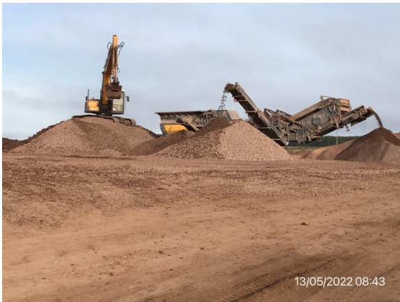
Ilustración 18 – P06, cantera de balasto. Sector de trituración. No hay infraestructura para mantenimiento mínimo de maquinaria o contingencias.
