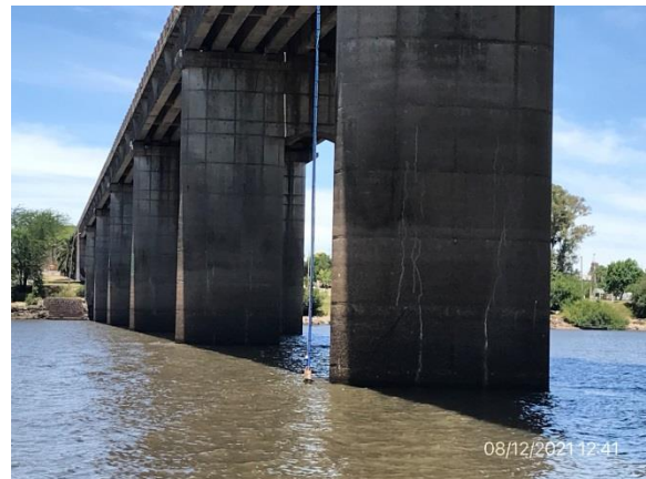
Ilustración 7 – P02, Puente de Ruta 2 sobre el río Negro, cabecera Norte. Toma de agua para utilización en hidrodemolición no cuenta con autorización de DINAGUA.
