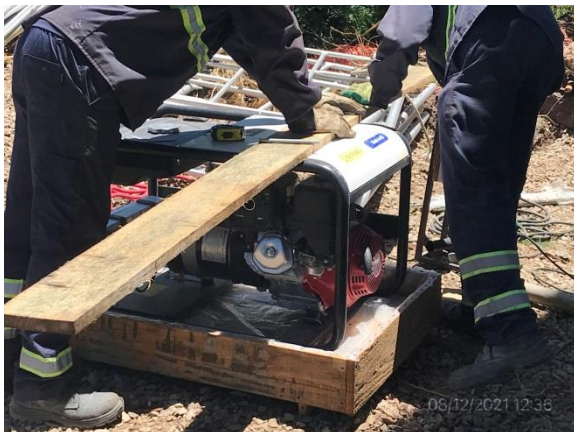
Ilustración 6 – P02, Campamento inferior en cabecera Norte del Puente de Ruta 2 sobre el río Negro. Generador eléctrico con bandeja impermeable adecuada
