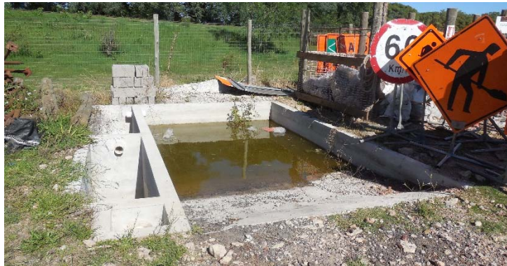
Figura 6-4 Pileta de lavado de mixer.
