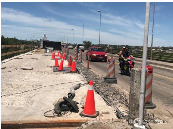
Ilustración 8 – Puente de Ruta 2 sobre el río Negro. Trabajos en ejecución sobre tablero.
