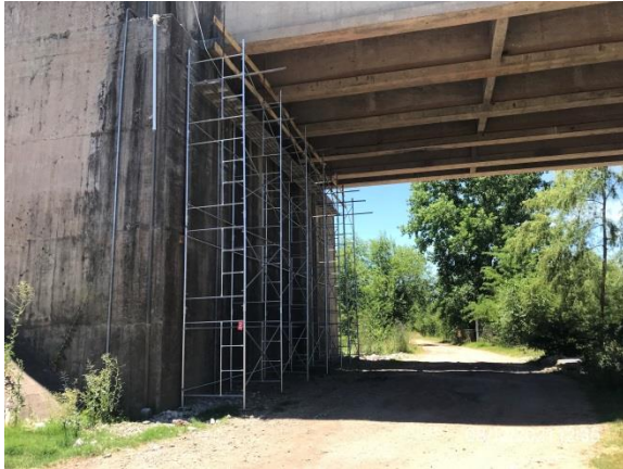
Ilustración 4 – P02, Campamento inferior en cabecera Norte del Puente de Ruta 2 sobre el río Negro. No hay infraestructura para la gestión de residuos de forma segregada. No hay delimitación de área inundable.
