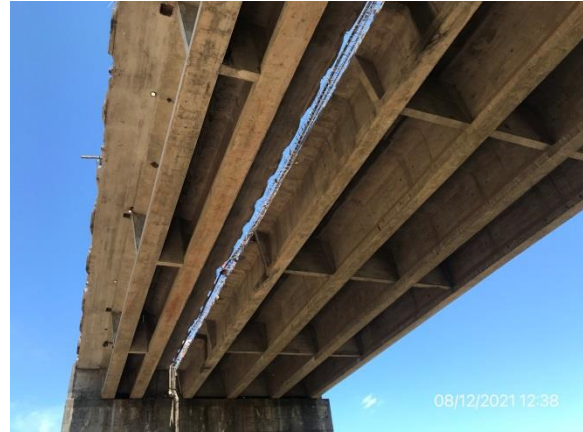
Ilustración 5 – Trabajos de demolición parcial en ejecución. Puente de Ruta 2 sobre el río Negro.
