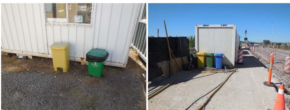
Figura 6-1 Recipientes para residuos en obrador principal y campamentos.
