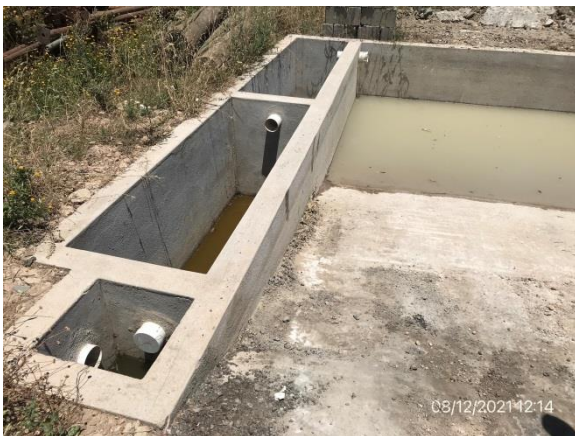
Ilustración 12 – P03, obrador principal. Pileta de decantación de aguas de lavado de camiones míxer.
