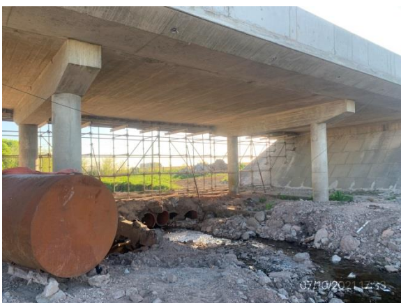
Ilustración 14 – P02, puente sobre A° Bizcocho en ejecución. No están indicadas las zonas de máxima creciente
