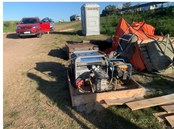
Ilustración 13 – P02, puente sobre A° Bizcocho. Campamento provisorio envallados correctos para equipamiento portátil.
