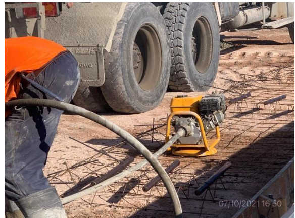
Ilustración 7 – P05, Pasaje superior sobre calle. Vibrador en funcionamiento sin contención para prevención de derrames.
