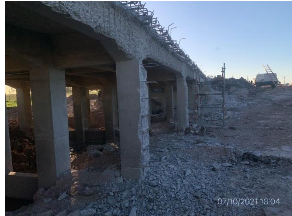
Ilustración 17 – P01, Puente sobre A° La Lancha. No están marcadas las zonas de máxima creciente.
