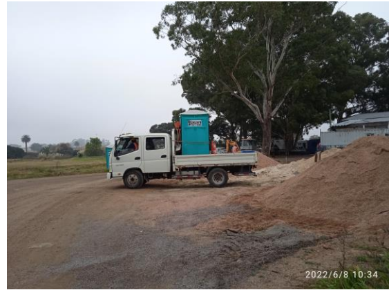
Ilustración 11 – P03, Obrador. Camión que transporta cuadrilla y baño químico a frente de obra
