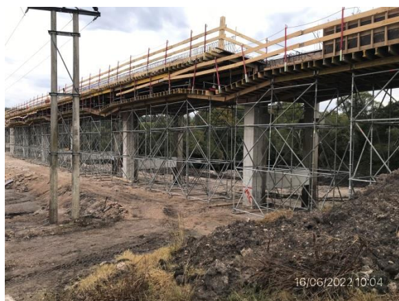
Ilustración 16 – P02, Puente sobre A° Don Esteban. Zona de obras en la planicie de inundación. No hay infraestructura para gestión de residuos.
