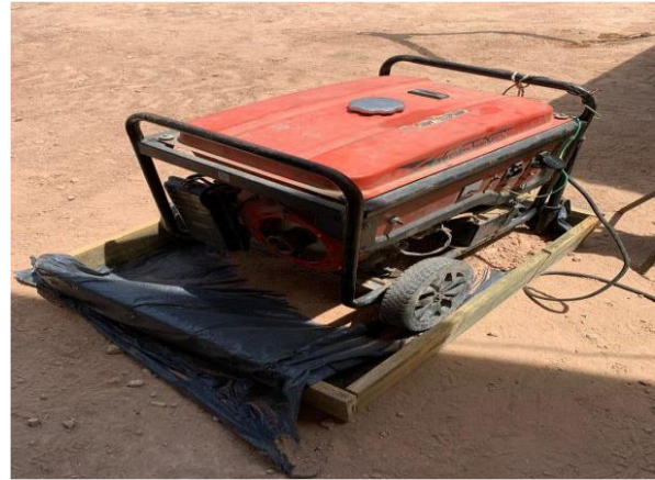
Ilustración 25 – P01, Puente sobre C da del Sauce. Generador eléctrico sobre bandeja impermeable. Fotografía del 17/01/2022 proporcionada por INCOCI.
