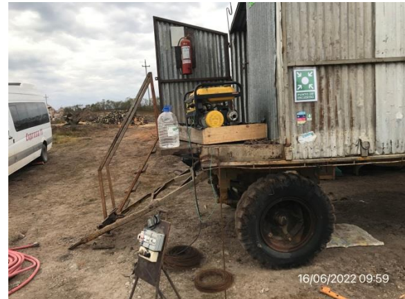
Ilustración 11 – P02, Puente sobre A° Don Esteban. Campamento provisorio. Generador eléctrico sobre bandeja estanca.
