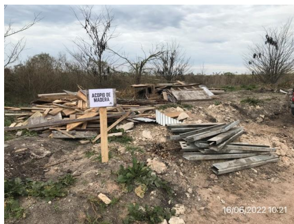
Ilustración 19 – P03, Puente sobre C da del Rosario. Acopio de ROCs y maderas fuera de zona de máxima creciente.
