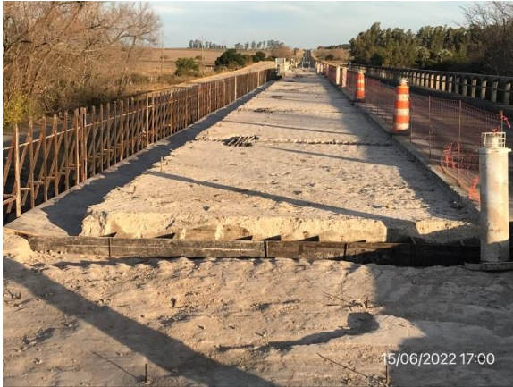
Ilustración 8 – P04. Puente sobre A° Quebracho. Tareas de ensanche de tablero en ejecución.
