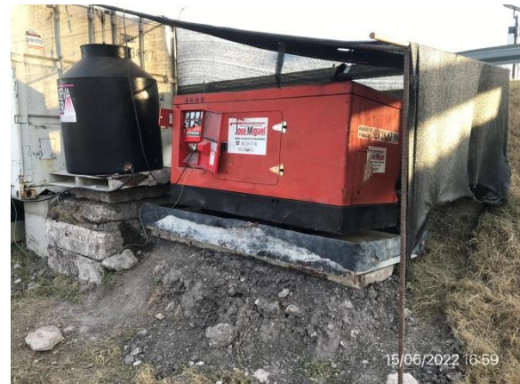
Ilustración 11 – P04. Campamento provisorio del Puente sobre A° Quebracho. Generador eléctrico emplazado en zona con vallado perimetral impermeable.
