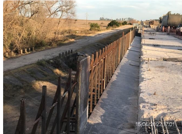
Ilustración 9 – P04. Puente sobre A° Quebracho. Tareas de refuerzo de vigas en ejecución.
