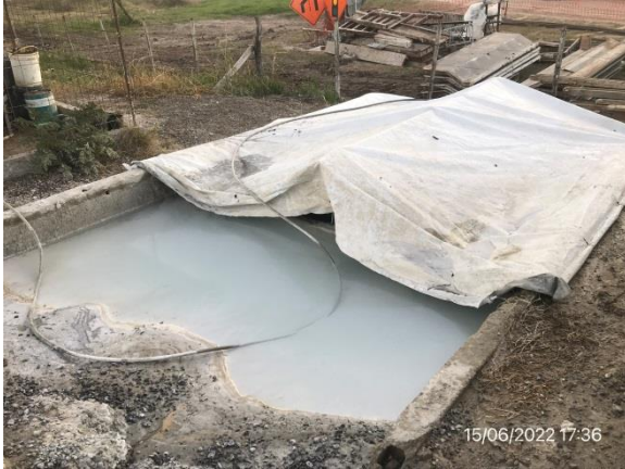
Ilustración 14 – P05 Obrador subcontratista Ingeniería Pacífico SA. Pileta de lavado de camión mixer.
