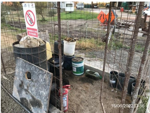
Ilustración 18 – P05 Obrador subcontratista Ingeniería Pacífico SA. Recinto techado y vallado para aceites y lubricantes.
