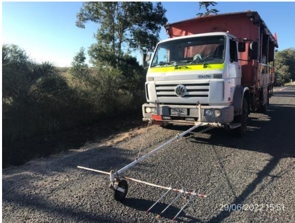
Ilustración 8 – P04, frente de obras. Ruta 13, progresiva 209K500. Tareas de demarcación horizontal en ejecución, subcontratista Bordonix SA.
