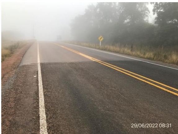
Ilustración 8 – P02. Fin de tramo. Ruta 8, progresiva 457K500.
