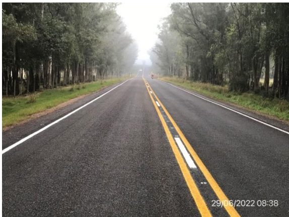
Ilustración 6 – Ruta 8. Nueva carpeta de rodadura en tratamiento bituminoso y nueva señalización horizontal terminadas.
