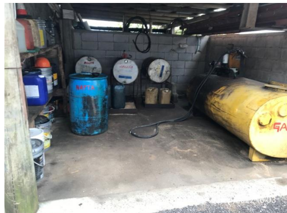
Ilustración 13 – P05, Obrador subcontratista Lemiro P. Pietroboni SA. Depósito de combustibles y lubricantes techado y con envallado perimetral y pavimento impermeable.
