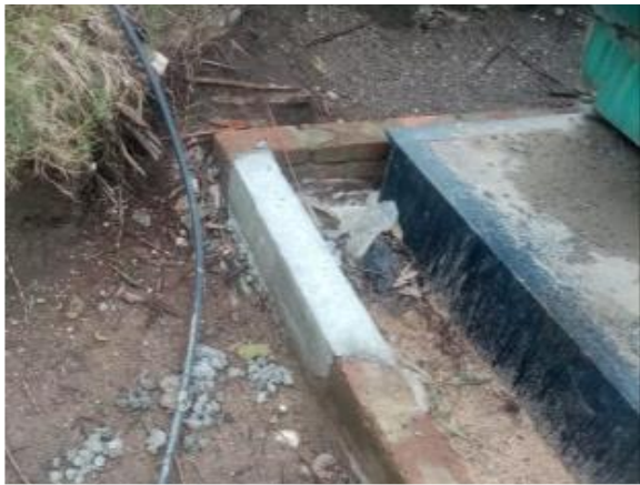
Ilustración 18 – P04, Obrador y Planta asfáltica, desmontados Padrón N° 31228. Envallado de grupo electrógeno reparado, fotografía remitida por la empresa el 04/10/2021.
