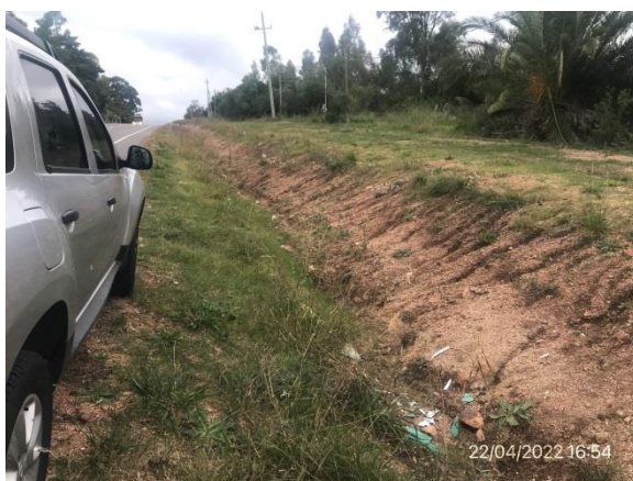
Ilustración 8 – P06, Taludes de cuneta en zona ensanchada con evidencias de erosión y falta de tapiz vegetal.
