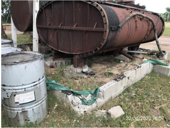
Ilustración 16 – P05, Obrador subcontratista Lemiro P. Pietroboni SA. Depósito de emulsiones asfálticas con envallado perimetral perforado.
