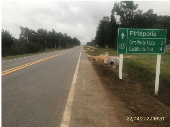
Ilustración 4 – P01, Inicio de tramo de obras de Ruta 37 en intersección con Ruta Interbalnearia
