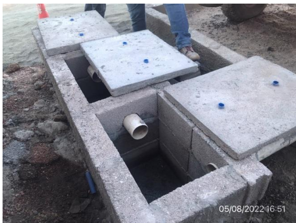
Ilustración 6 – P03, Obrador. Infraestructura para decantación de efluentes.
