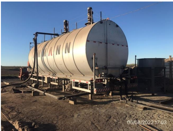
Ilustración 12 – P03, Planta asfáltica. No hay contenciones perimetrales ni pavimento impermeable.
