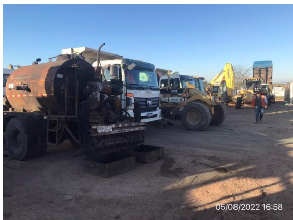
Ilustración 8 – P03, Obrador. Parque de maquinaria disponible en el obrador, no se aprecia ningún sector para acopio de restos de mezcla asfáltica.
