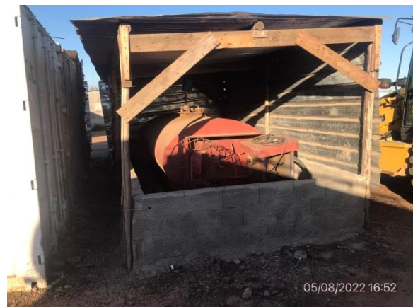
Ilustración 7 – P03, Obrador. Infraestructura envallada para alojar tanque de combustible.
