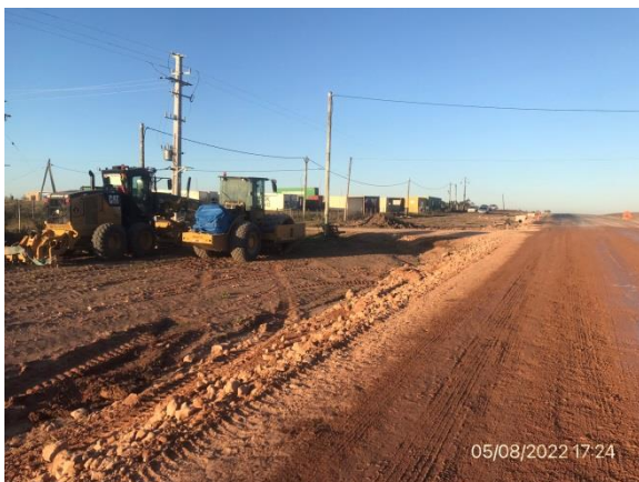
Ilustración 14 – P04, Frente de obras. Ruta 81, progresiva 51K400. Tareas de recargo granular en curso.
