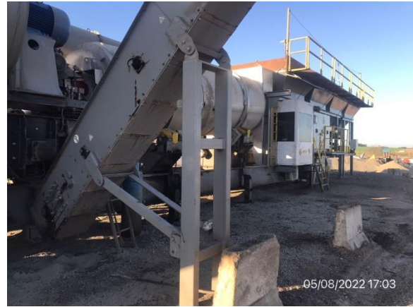
Ilustración 11 – P03, Planta asfáltica. No hay contenciones perimetrales ni pavimento impermeable.
