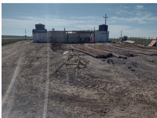
Ilustración 24- Obrador CIEMSA, almacenamiento de productos químicos, ruta 5, 309K100 a (+)
