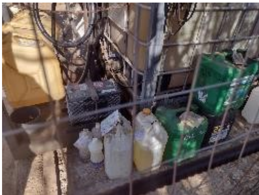
Ilustración 12- Almacenamiento de productos químicos en obrador SACEEM 250K460
