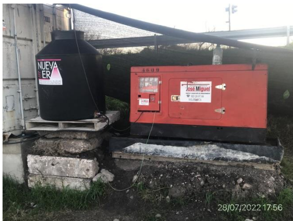
Ilustración 18 – P04, Puente sobre A° Quebracho. Campamento provisorio. Generador eléctrico con contención perimetral
