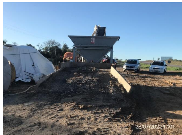
Ilustración 19 – P05, Obrador subcontratista Ingeniería Pacífico SA. Planta de hormigón.
