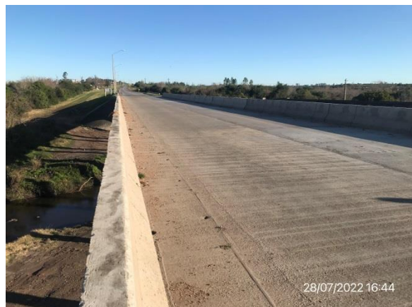
Ilustración 7 – P01, Puente sobre A° San Francisco Grande. Tablero superior con trabajos parcialmente terminados
