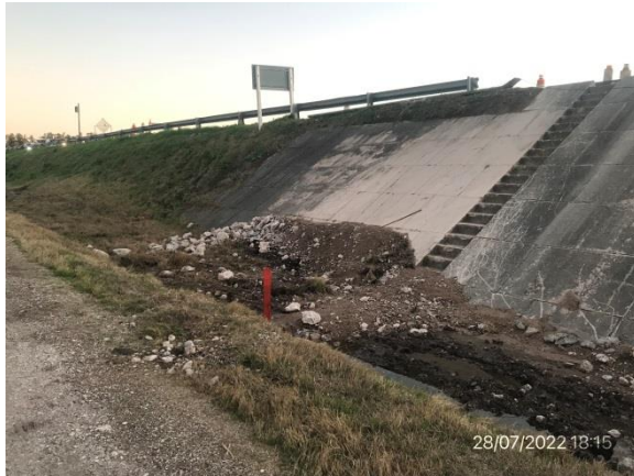
Ilustración 16 – P04, Puente sobre A° Quebracho. Demarcación de máxima creciente realizada.
