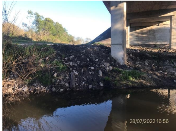
Ilustración 11 – P02, Puente sobre A° San Francisco Chico. Planicie de inundación con residuos de obra sin retirar
