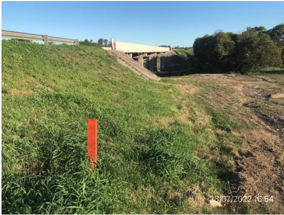
Ilustración 10 – P02, Puente sobre A° San Francisco Chico. Demarcación de zona de máxima creciente.
