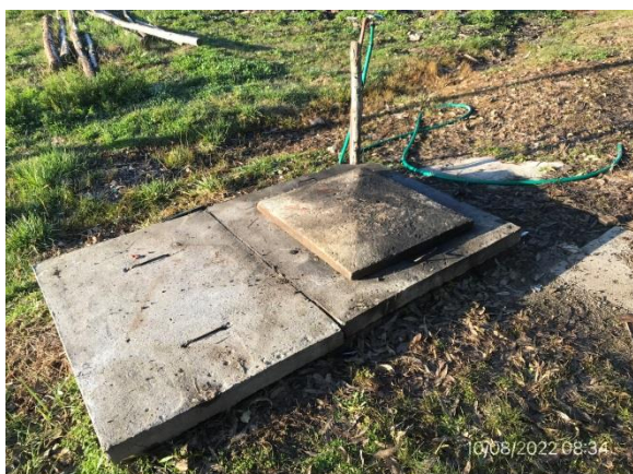
Ilustración 12 – P05, Obrador subcontratista Lemiro Pietroboni SA, Cámara interceptora de líquidos contaminados con hidrocarburos.
