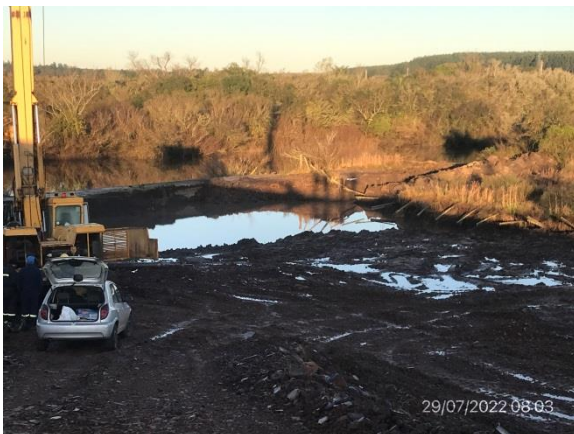
Ilustración 14 – P02, Puente sobre A° Tres Cruces. Excavación adyacente a estructura de protección de crecidas con fines de extracción de material de ataguía y volumen que excedió autorización DNV.
