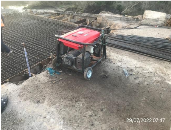
Ilustración 10 – P01, Puente sobre río Tacuarembó Chico. Generador eléctrico sin barrera impermeable de prevención de derrames.
