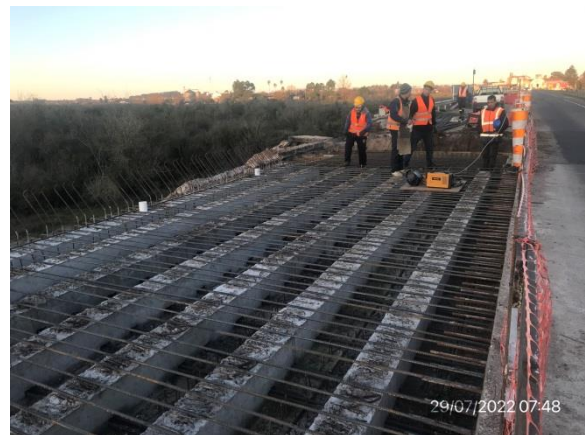
Ilustración 9 – P01, Puente sobre río Tacuarembó Chico. Trabajos sobre tablero superior. Falta infraestructura para gestión de residuos.
