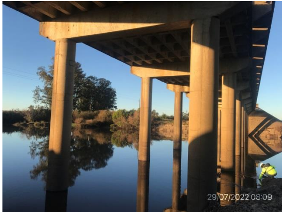
Ilustración 16 – P02, Puente sobre A° Tres Cruces. Tablero superior a ser demolido y reemplazado.
