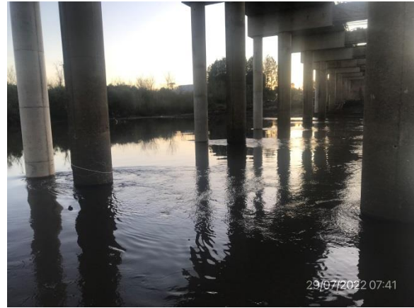
Ilustración 11 – P01, Puente sobre río Tacuarembó Chico. Curso de agua crecido, impide comprobar la efectiva remoción de escombros.
