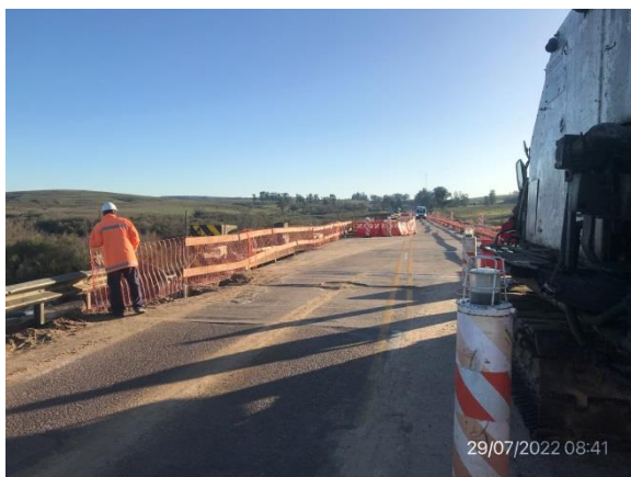
Ilustración 20 – P03, Puente sobre río Tacuarembó Grande. Sector de trabajo de Viermond SA en zona de tablero superior, no hay infraestructura para gestión de residuos.
