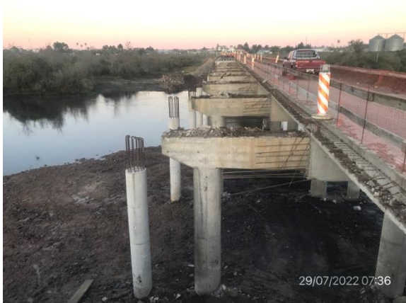
Ilustración 4 – P01, Puente sobre río Tacuarembó Chico. Nuevos pilares construidos en senda a (+).
