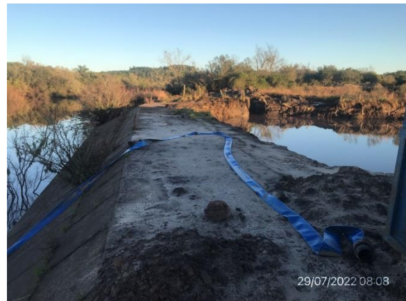
Ilustración 13 – P02, Puente sobre A° Tres Cruces. Excavación adyacente a estructura de protección de crecidas con fines de extracción de material de ataguía y volumen que excedió autorización DNV.
