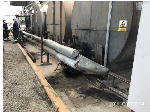
Ilustración 11 – P04, Obrador. Planta asfáltica. Envallados perimetrales para contención de derrames.
