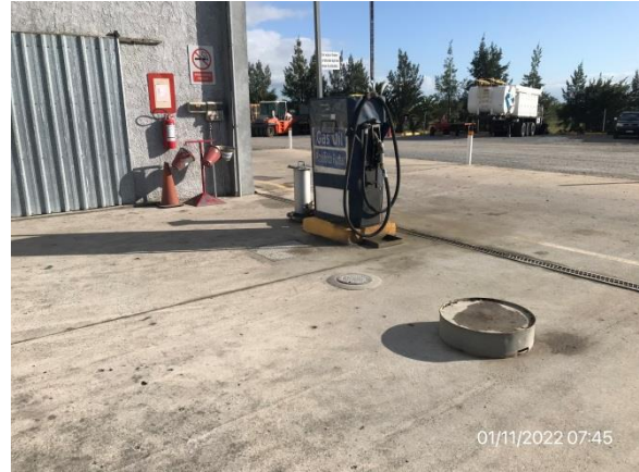
Ilustración 5 – P04, Obrador. Estación de abastecimiento de combustible en explanada con pendientes hacia sistema de tratamiento de efluentes.
