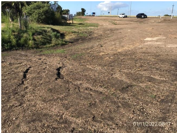
Ilustración 18 – P03, Rotonda terminada. Falta empastado vegetal en faja pública y existen señales de erosión.
