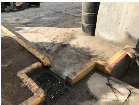
Ilustración 14 – P04, Obrador. Explanada de lavado de camiones con pendiente hacia trampa de grasas y sistema de efluentes.
