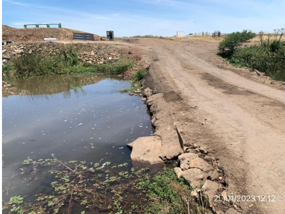
Ilustración 22 – P02, puente sobre A° Isla de Argüello. Alcantarilla preexistente en badén con sección obstruida
