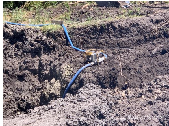
Ilustración 13 – P01, puente sobre A° Tres Árboles. Motobomba en funcionamiento sin elementos de contención de derrames.
