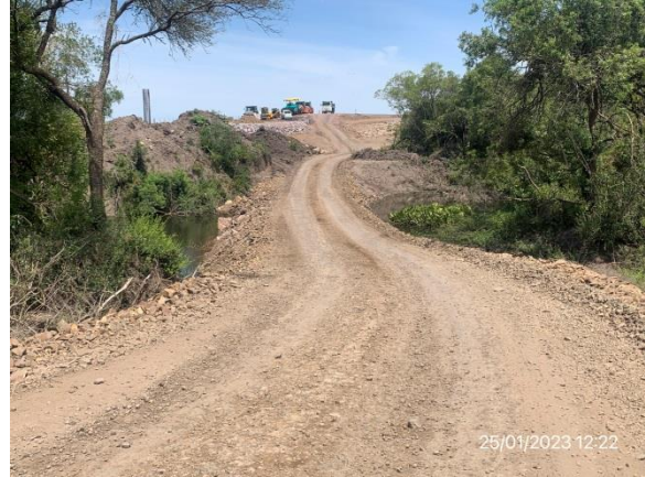
Ilustración 23 – P01, puente sobre A° Tres Árboles. Badén preexistente sin elementos de conducción del cauce.
