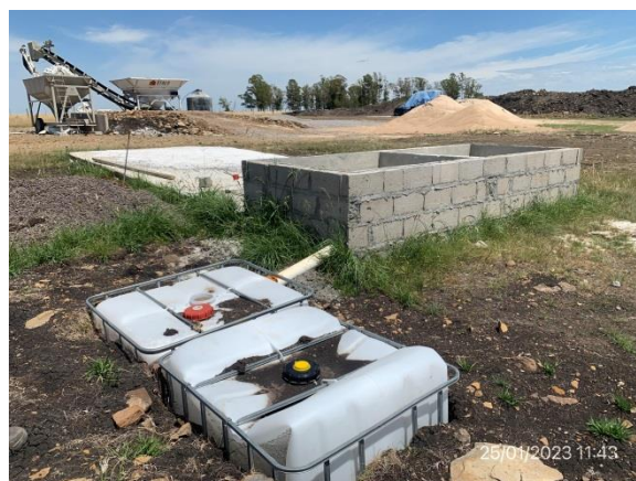
Ilustración 9 – P01, obrador principal, planta de hormigón. Pileta de decantación de aguas de lavado de camiones mixer.
