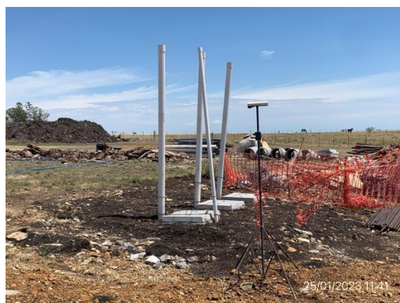
Ilustración 7 – P01, obrador principal. Depósito impermeable para aguas servidas.
