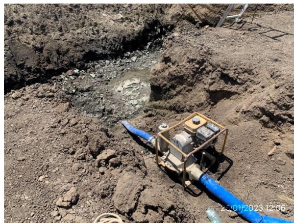
Ilustración 17 – P02, puente sobre A° Isla de Argüello. Motobomba en funcionamiento sin elementos de contención de derrames.
