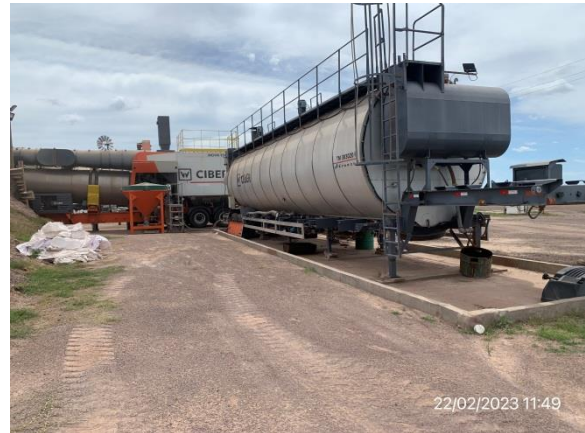
Ilustración 11 – P03, Obrador central. Depósito de asfaltos con envallado perimetral.
