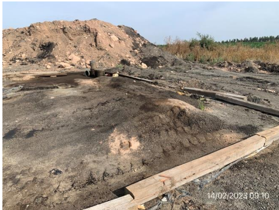
Ilustración 16 – P03, Obrador Principal. Sector de acopio en malas condiciones de tarrinas con hidrocarburos usados. No existe contención perimetral de efluentes líquidos.
