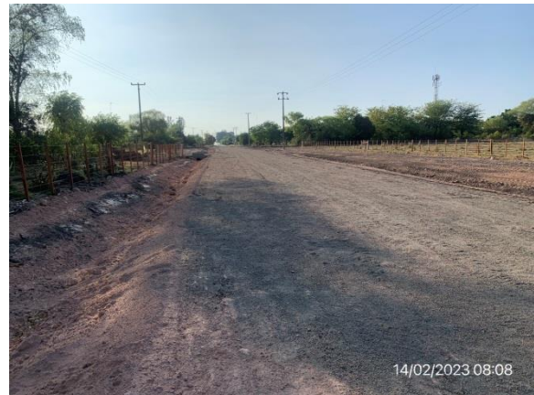
Ilustración 5 – P02, fin de tramo. Sector de 270 m. en ejecución, frente de obra Ruta 81 progresiva 42K300, San Bautista. Base granular ejecutada
