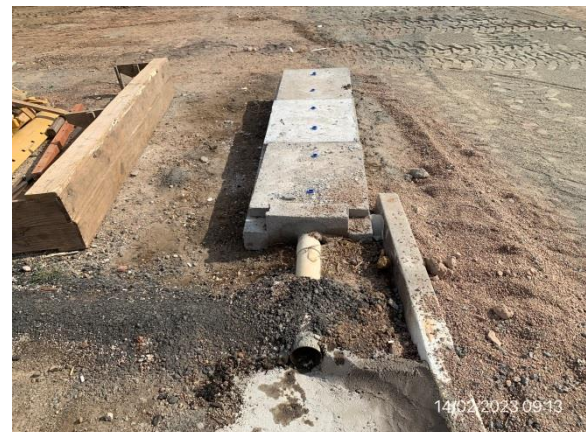
Ilustración 19 – P03, Obrador Principal. Sector de mantenimiento liviano, punto de recolección y separación de efluentes con hidrocarburos. .
