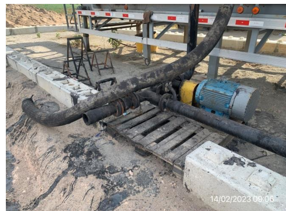
Ilustración 15 – P03, Planta asfáltica, zona perforada del envallado perimetral
