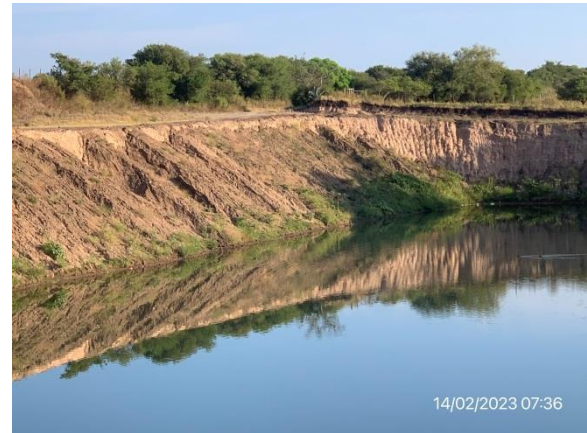
Ilustración 11 – P05, Cantera de tosca. Padrón rural N°15393 15ª SC, Canelones. Ruta 81, progresiva 22K600 a (-). Taludes suavizados.
