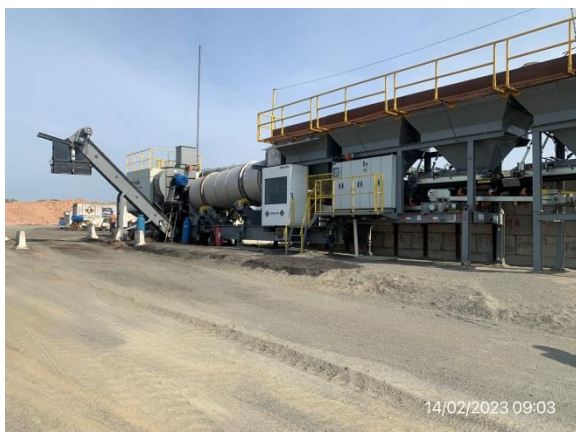
Ilustración 14 – P03, Obrador Principal. Ruta 81, progresiva 16K400 a (-). Planta asfáltica con envallado perimetral.
