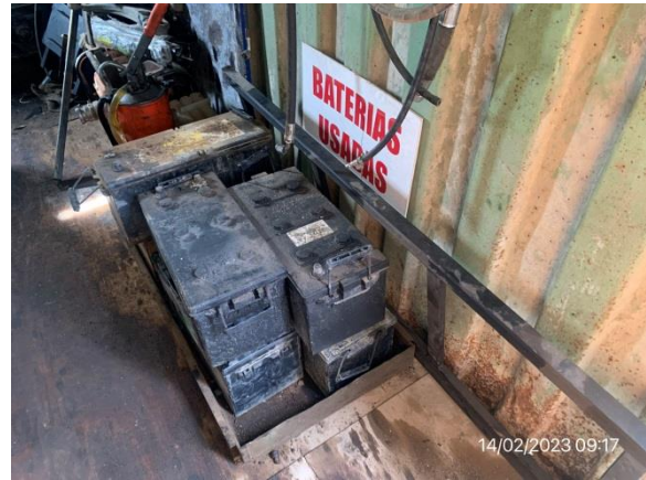
Ilustración 23 – P03, Obrador Principal. Pañol cerrado, sector de acopio de baterías.
