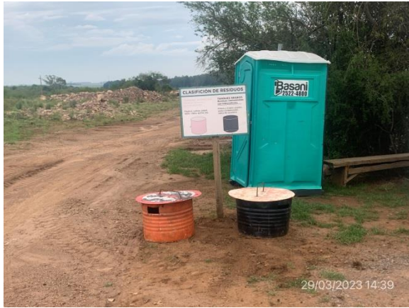
Ilustración 16 – P04, Cantera. Baños químicos y estación de residuos segregados por canal de generación.
