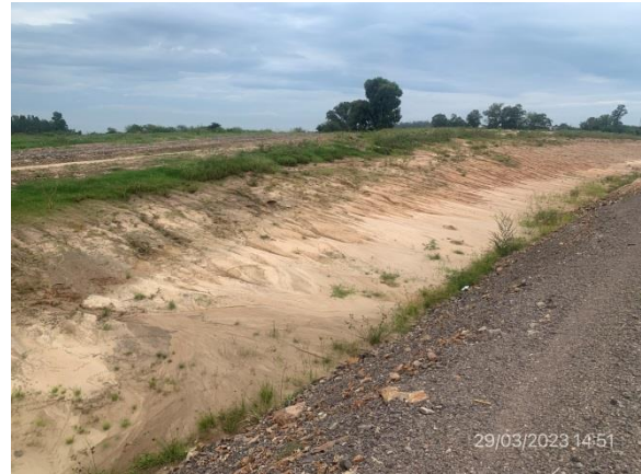
Ilustración 11 – Bypass Centenario, taludes en faja pública erosionados, senda a (+).
