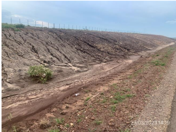
Ilustración 10 – Bypass Centenario, taludes en faja pública erosionados, senda a (-).
