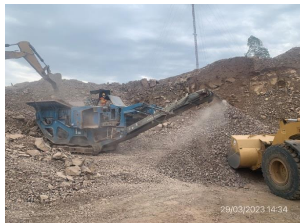
Ilustración 15 – P04, Cantera. Trituración de material en proceso. No hay medios para abatimiento de emisiones.
