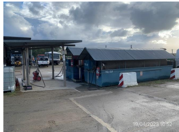
Ilustración 9 – P05. Obrador. Depósitos de combustible con envallado y techo.
