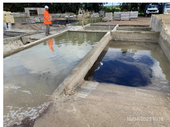
Ilustración 15 – P03, Obrador. Pileta de lavado de camiones mixer desbordada y trasegando aguas contaminadas con hidrocarburos a pileta contigua y con sistema precario de retención de grasas y aceites
