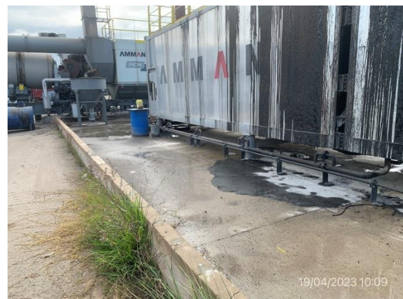
Ilustración 9 – P03. Planta asfáltica con evidencia de derrames correctamente contenidos por la estructura impermeable existente, pero sin limpieza de los mismos.
