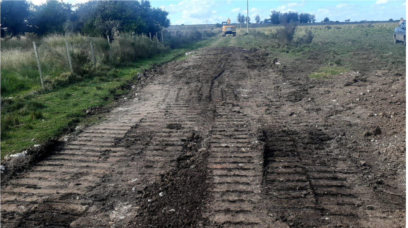
Mejorado de camino en terreno privado, previa solicitud del propietario, reciclando escombros de construcción.
