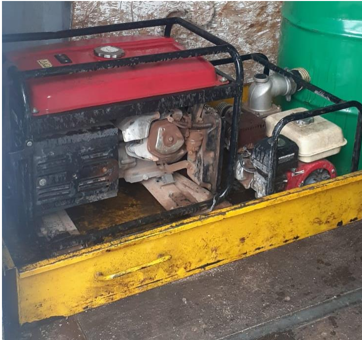
Imagen 1 – Motobomba y generador en bandeja antiderrames en obrador.
