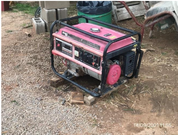
Ilustración 10 – P04, Cantera de arenisca. Grupo electrógeno sin estructura de contención de derrame de combustibles.
