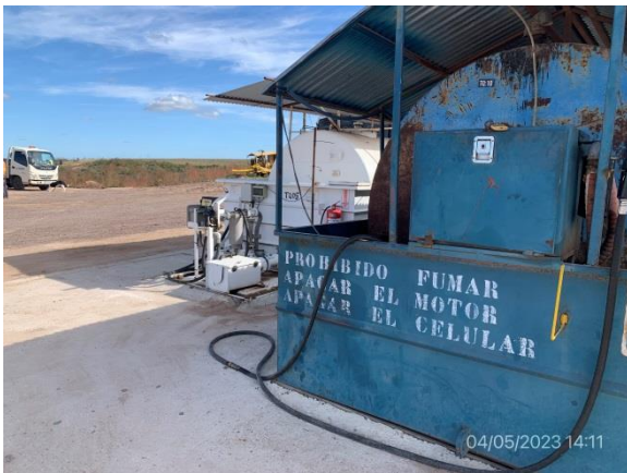
Ilustración 12 – P03, Obrador principal. Depósito de combustible con vallado perimetral.
