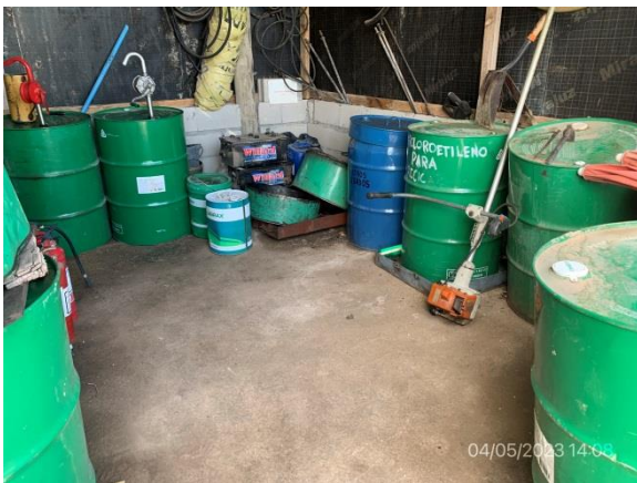
Ilustración 14 – P03, Obrador principal. Acopio de lubricantes en sector con pavimento y vallado impermeables.
