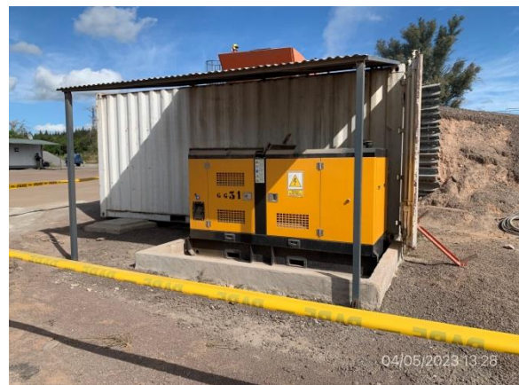
Ilustración 7 – P05, Planta asfáltica. Generador eléctrico secundario techado y con vallado perimetral.
