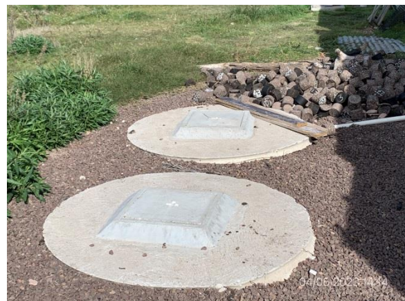
Ilustración 21 – P03, Obrador principal. Pozo impermeable para aguas servidas domésticas.
