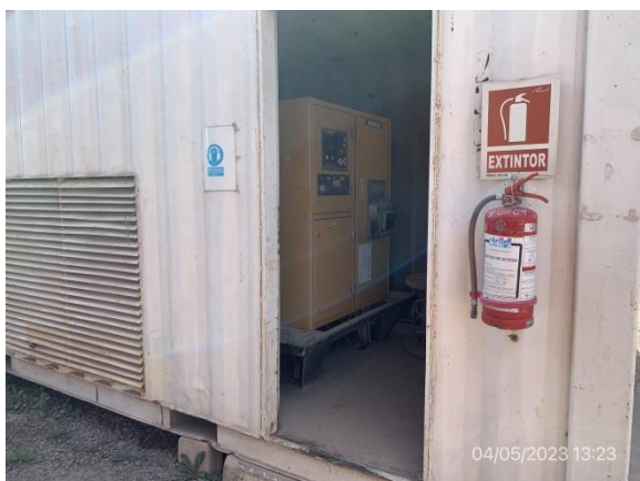
Ilustración 8 – P05, Planta asfáltica. Generador eléctrico primario ubicado en local cerrado.
