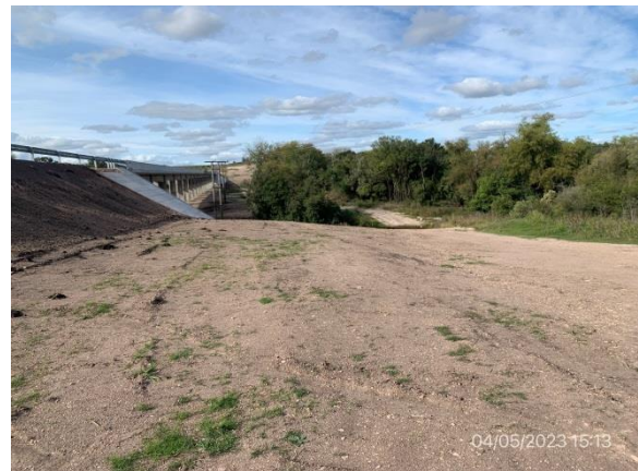
Ilustración 9 – P02, Puente sobre A° Don Esteban. Campamento provisorio desmontado y recuperación ambiental terminada, zona limpia de residuos.
