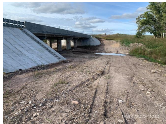
Ilustración 15 – P01, Puente sobre C da del Sauce. Campamento provisorio desmontado y recuperación ambiental terminada, zona limpia de residuos.
