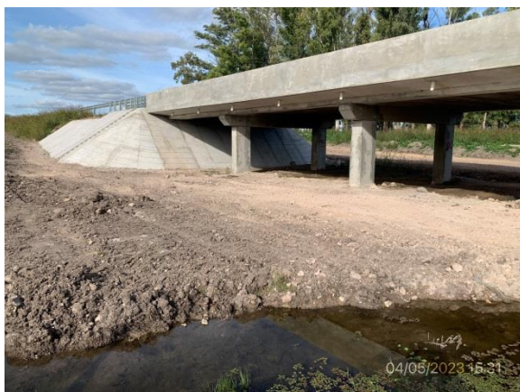
Ilustración 14 – P01, Puente sobre C da del Sauce. Curso de agua limpio y sin ROCs u otros residuos.
