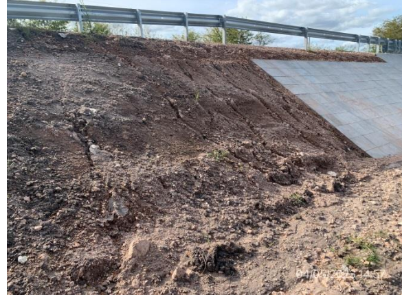
Ilustración 5 – P03, Puente sobre C da del Rosario, talud sobre senda a (+) con erosión por escurrimiento pluvial.
