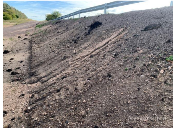
Ilustración 11 - P02, Puente sobre A° Don Esteban. Talud sobre senda a (+) con erosión por escurrimiento pluvial.
