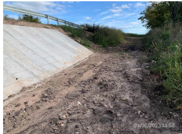
Ilustración 7 – P03, Puente sobre C da del Rosario Campamento provisorio desmontado y recuperación ambiental terminada, zona limpia de residuos.
