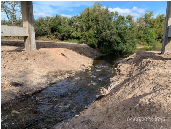
Ilustración 10 – P02, Puente sobre A° Don Esteban. Curso de agua limpio y sin ROCs u otros residuos.
