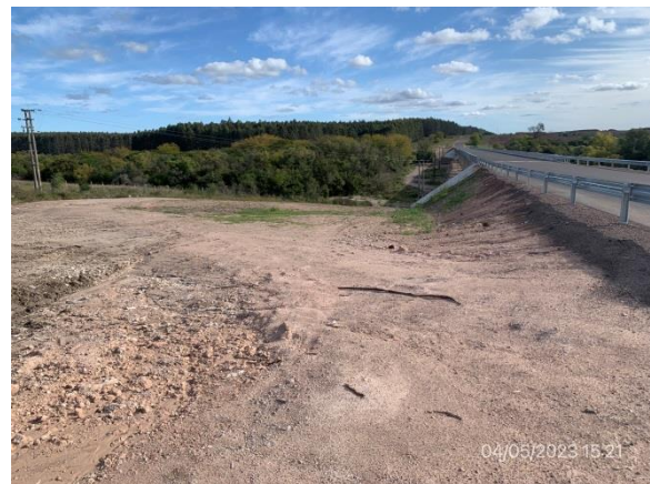
Ilustración 13 – P01, Puente sobre C da del Sauce. Taludes con empastado en crecimiento, con erosión por escurrimiento pluvial.
