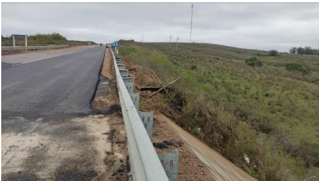
Foto 12.1-1 Restos de materiales en talud próximo a cuarto cono.
