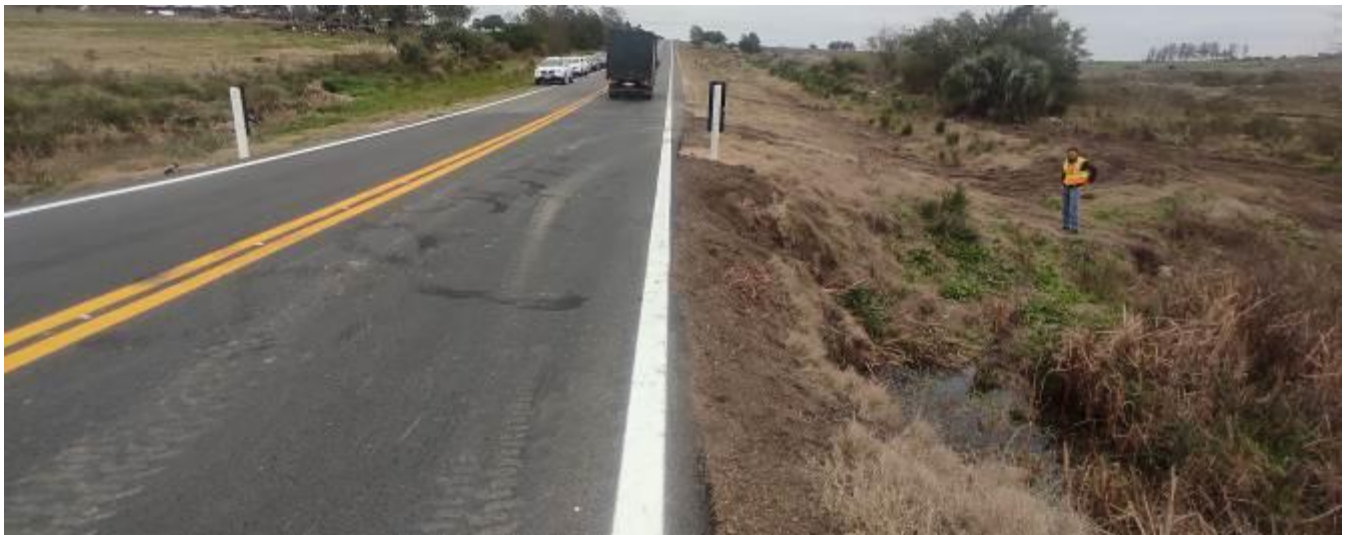
Foto 12.1-1 Vta.2 - Erosión en banquina.
