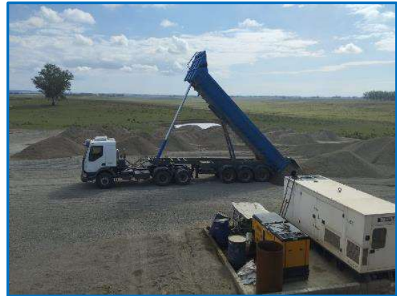
Transporte de agregados para MAC y generador en recinto estanco.
