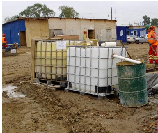
Figura 3-9 Pileta de lavado para canaletas de mixer
