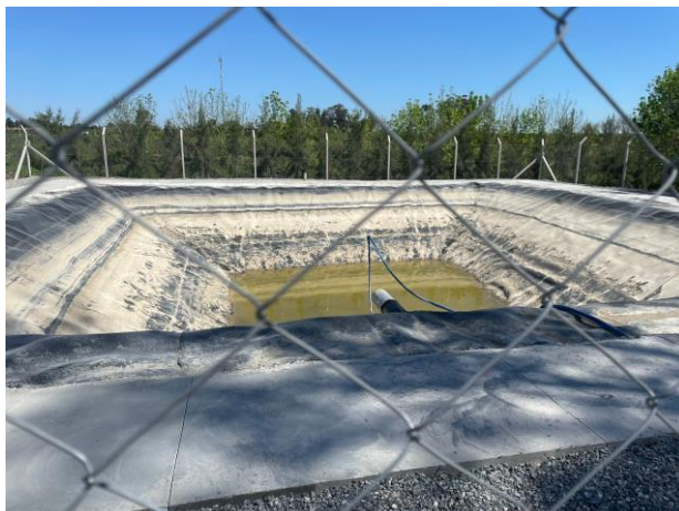
Pileta de acumulación de pluviales – Vialmix
