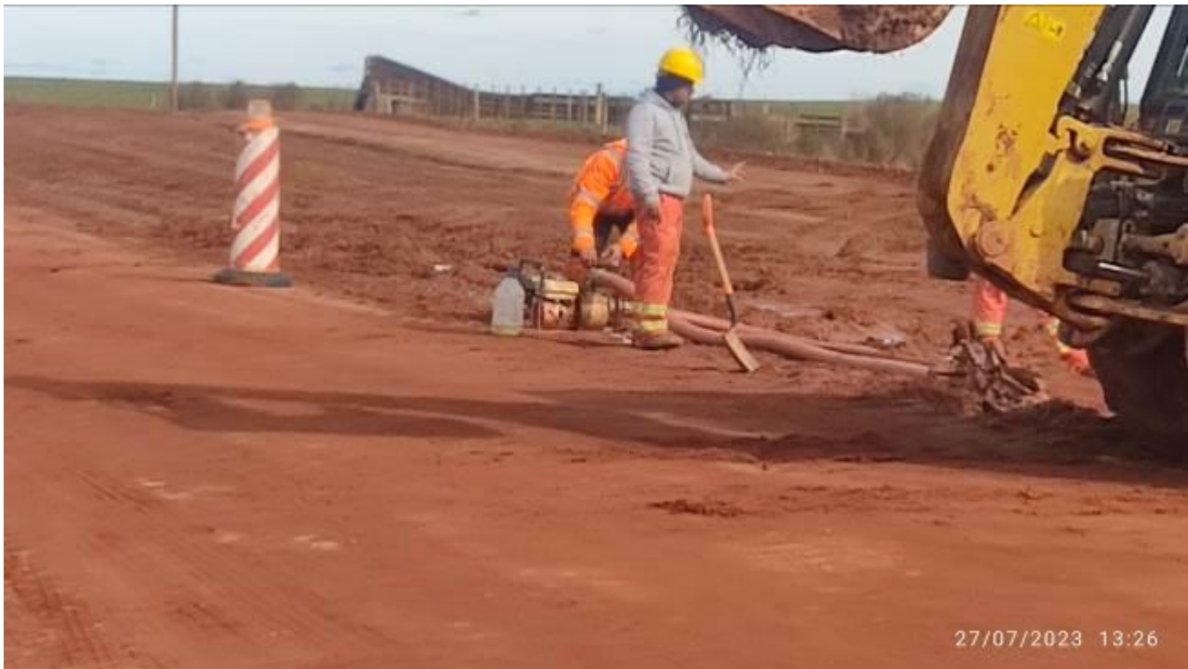
Foto 11.1-1 Tanque de Combustible sin contención.
