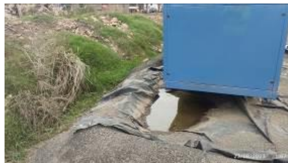
Foto 12.2-1 Dique de generador eléctrico inadecuado.
