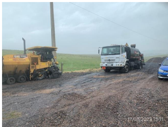
Foto 12.2-2. No se observa infraestructura para gestión de residuos ni atención de contingencias ambientales.
