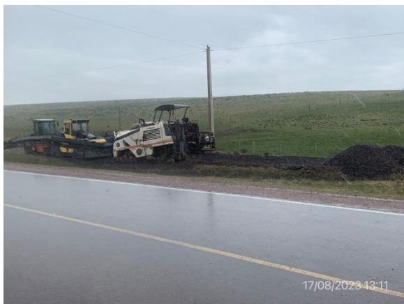
Foto 12.2-1. Ruta 8 progresiva 373K100, sendas a (+) y a (-).
