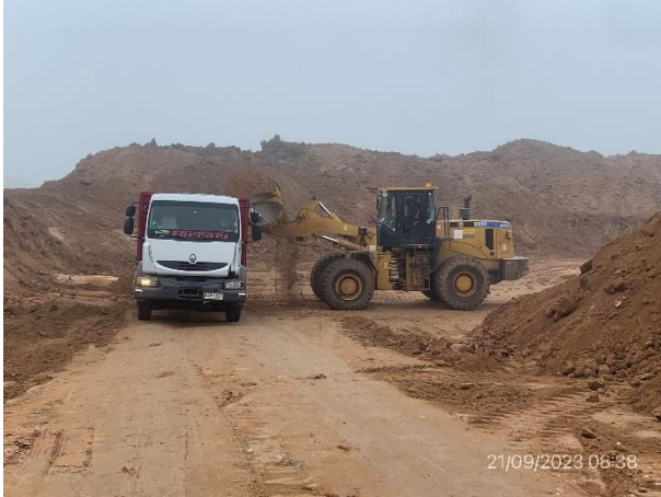
Foto 12.2-1, P03. Cantera y obrador en proceso de montaje. Ruta 6 progresiva 185K000 a (-). Aún no se instalaron baños químicos cercanos al frente de explotación
