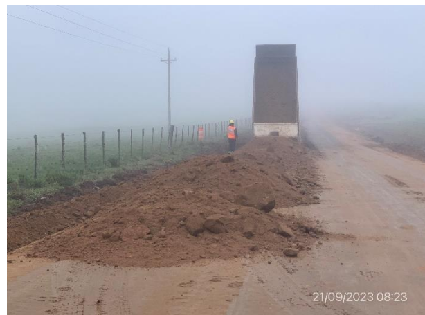
Foto 12.1-6, P05, Frente de obras de bacheo y ensanche de plataforma. Ruta 6 progresiva 189K500..
