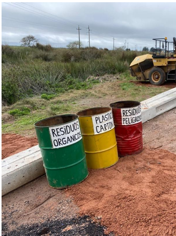
Foto 12.2-5, P03. Se sustituyó el suelo contaminado y se instaló estación para acopio de residuos segregados por corriente de generación, aunque sin tapa.
