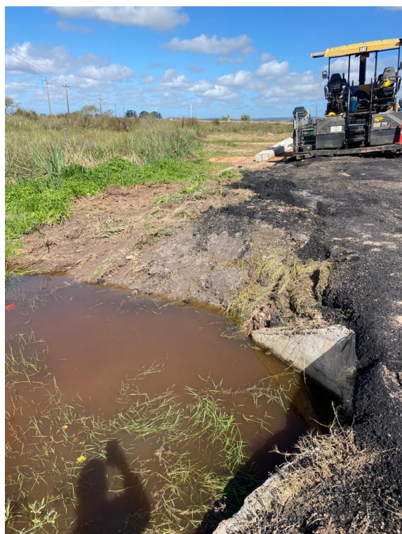
Foto 12.2-3. P03. Se retiró el sobrante de mezcla asfáltica originalmente dispuesto en cuneta inundada
