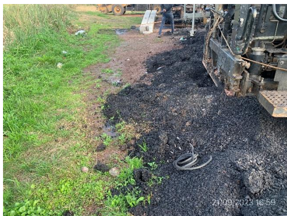
Foto 12.1-7, P03. Campamento móvil en frente de obra. Residuos sin disposición correcta
