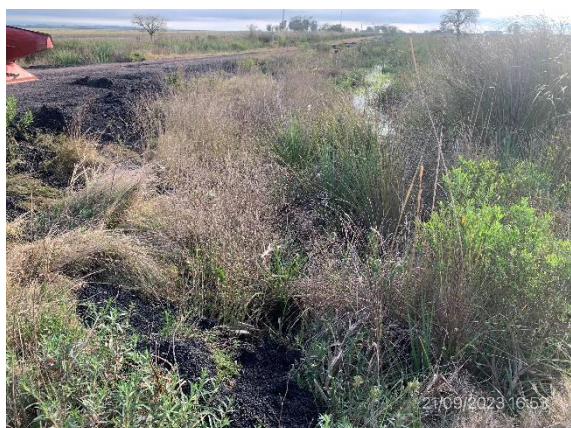
Foto 12.1-9, P03, Frente de obra. Disposición de sobrante de mezcla asfáltica en cuneta inundada..
