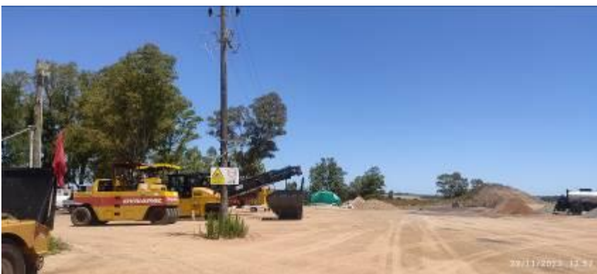
Foto 12.2-1 Equipos estacionados bajo tendido de media tensión.
