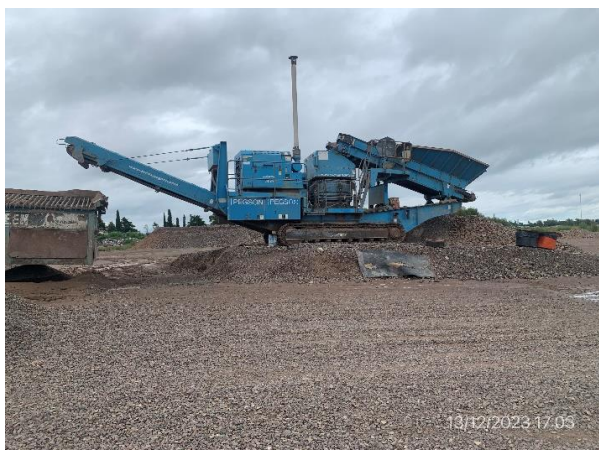
Foto 12.1-17, P04. Trituradora secundaria en mantenimiento. Hay tarrinas para acopio temporal de residuos segregados.
