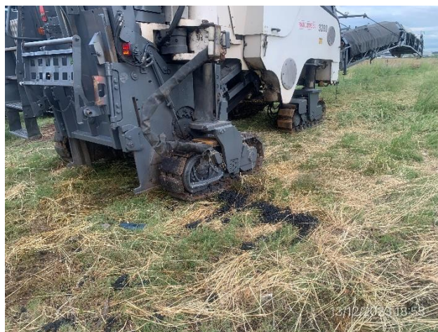
Foto 12.2-6, P06. Derrames de emulsión asfáltica sobre suelo desnudo, sin ser dispuestos transitoriamente.
