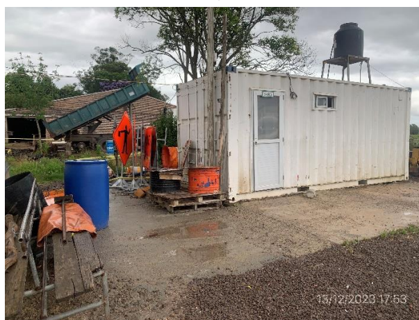
Foto 12.1-20, P03. Obrador, estación de acopio de residuos segregados por corriente de generación. Tanque elevado de agua no potable proveniente de perforación.
