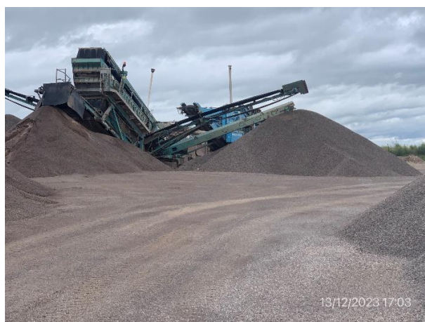
Foto 12.1-16, P04. Planta Asfáltica, tren de trituración y acopio de áridos triturados.
