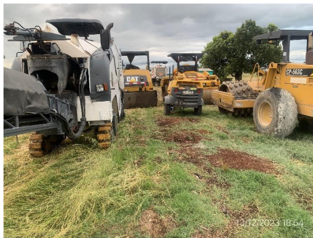
Foto 12.2-4, P06. Estacionamiento en faja pública de Ruta 4 y frente de obra, Ruta 1 progresiva 171K200.
