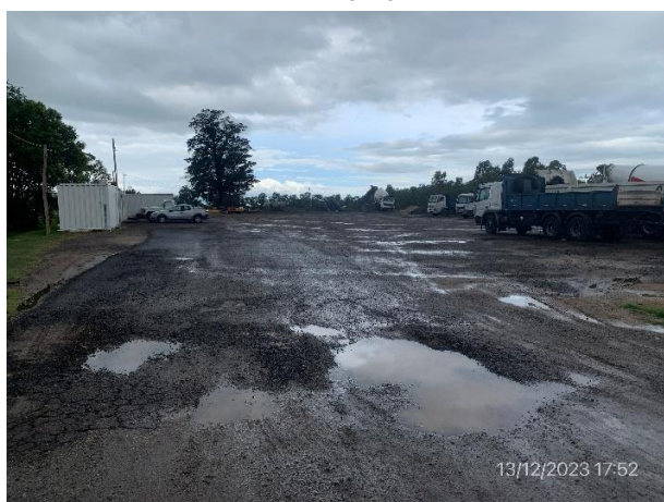
Foto 12.1-19, P03. Obrador, padrones N°10698 y N°10705 de la 1ª SC de Durazno, Ruta 5 progresiva 175K200 a (+).
