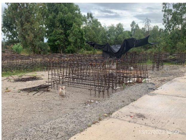
Foto 12.1-27, P03. Plataforma de elaboración de vigas New – Jersey, no hay infraestructura para acopio de residuos.
