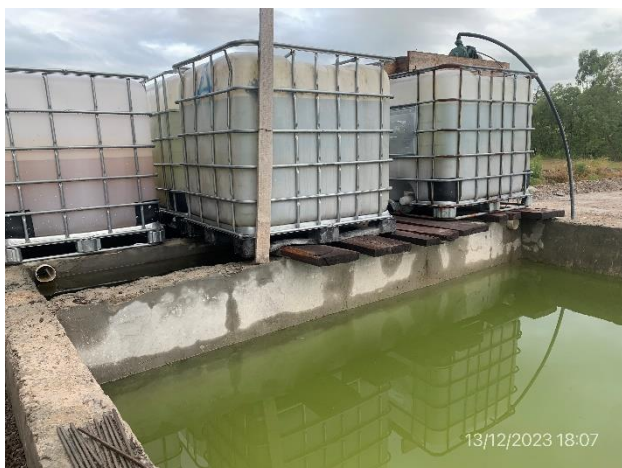
Foto 12.1-25, P03. Obrador, planta de hormigón. Sector de sedimentación y recirculación de aguas de lavado.
