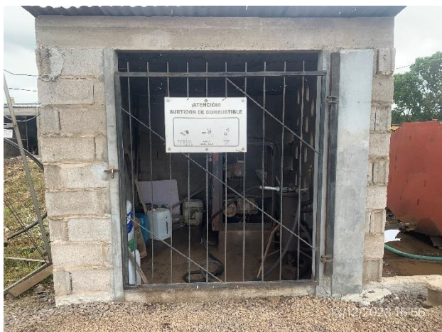
Foto 12.1-9, P04. Planta Asfáltica, surtidor de combustible en recinto envallado impermeable.
