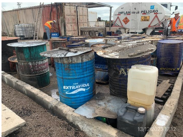
Foto 12.1-13, P04. Planta Asfáltica, el sector envallado para acopio de tarrinas con lubricantes usados tiene su capacidad colmada.
