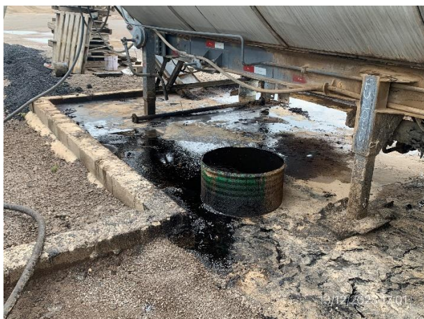
Foto 12.1-11, P04. Planta Asfáltica, con envallado perimetral adecuado. Hay derrames asfálticos, que aún no fueron dispuestos adecuadamente.
