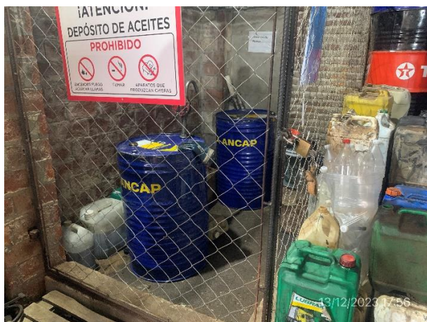
Foto 12.1-21, P03. Obrador, taller mecánico y pañol con sector envallado para alojar tarrinas de lubricantes
