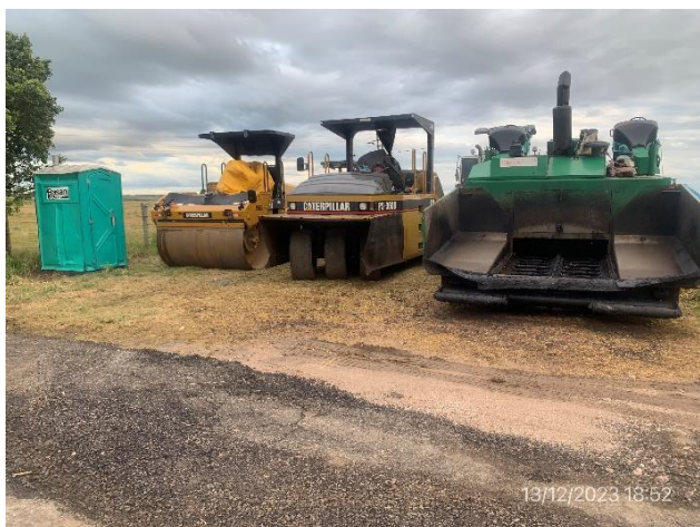
Foto 12.2-5, P06. Ausencia de infraestructura propia de campamento móvil: servicios de bienestar e infraestructura para gestión segregada de residuos.
