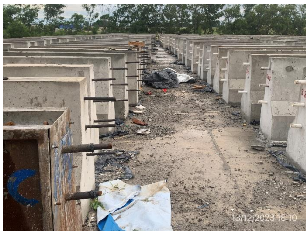
Foto 12.1-28, P03. Plataforma de elaboración de vigas New – Jersey, residuos dispersos sin disponer.
