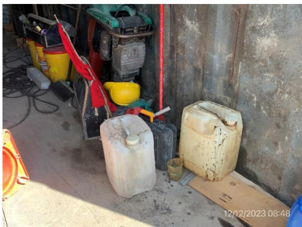
Foto 12.1-5, P03. Obrador, pañol con recipientes de combustibles fuera de sectores envallados.
