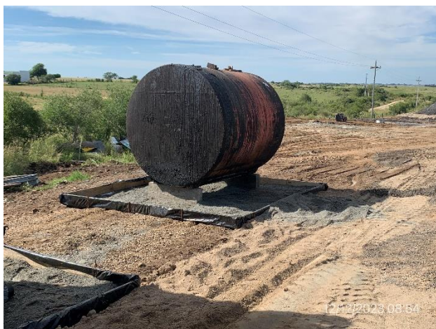
Foto 12.1-11, P03. Planta asfáltica, depósito de emulsión asfáltica en sector envallado, no alcanza a contener el 110% del volumen del tanque.
