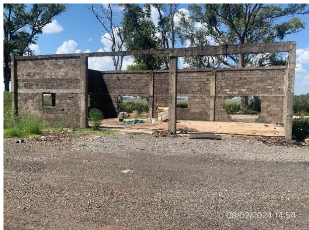
Foto 12.1-3, P03. Pañol a cielo abierto, quedan residuos sin disponer adecuadamente.
