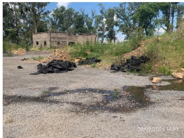
Foto 12.1-4, P03. Plataforma de maniobras, quedan residuos sin disponer adecuadamente.
