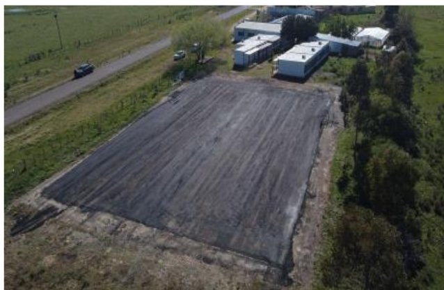
Foto 12.3-3, Área deportiva de la escuela rural N°79 y Liceo de Masoller. Explanada en mezcla asfáltica en área deportiva.
