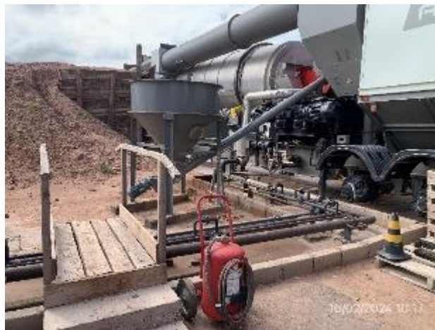
Foto 12.1-8, P03. Planta asfáltica con actividad detenida. Envallado perimetral correcto.
