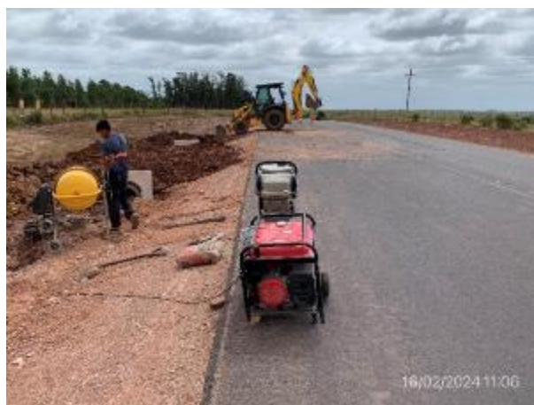
Foto 12.2-4, P10. Trabajos en ejecución sin condiciones de confort para operarios. Generador carece de bandeja para prevención de derrames de combustible.
