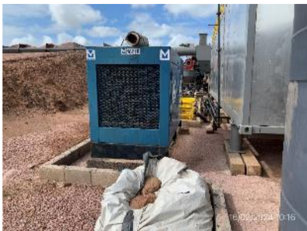
Foto 12.1-9, P03. Planta asfáltica, generador alojado en zona con envallado perimetral.
