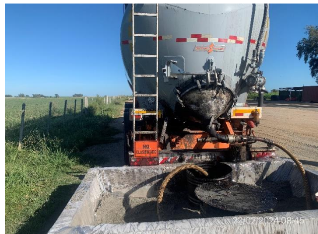
Foto 12.1-6, P03. Obrador, cisterna de emulsión asfáltica con zona de manipuleo en recinto envallado.
