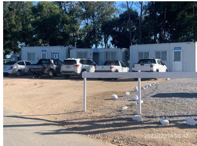
Foto 12.1-2, P03. Obrador, explanada de maniobras y en condiciones apropiadas de orden y limpieza.
