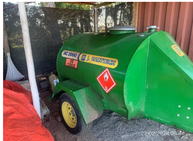
Foto 12.1-4, P03. Tanque de combustible alojado en recinto techado y con pavimento impermeable envallado.
