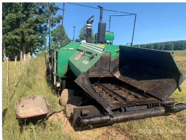
Foto 12.3-4, P08. Campamento móvil en faja pública, Ruta 30 progresiva 242K300 a (-). No cuenta con las infraestructuras previstas en el PGA.
