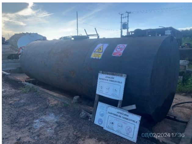
Foto 12.1-5, P05. Depósito de combustible en local envallado a cielo abierto.
