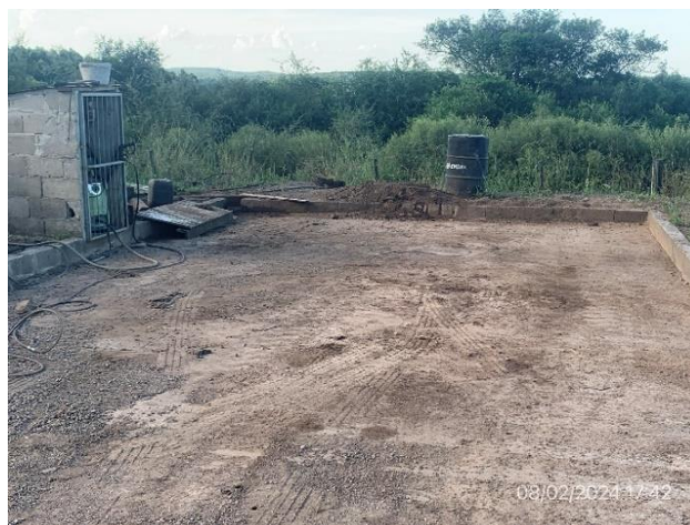
Foto 12.1-6, P05. Zona de lavado de camiones con pendiente hacia punto bajo de recolección de aguas.
