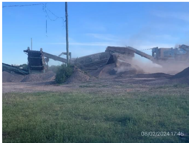
Foto 12.1-2, P05. Tren de trituración y zarandeo.
