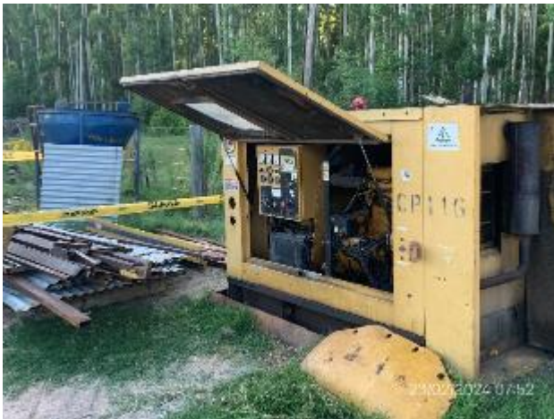
Foto 12.2-9, P03. Obrador secundario, generador eléctrico alojado dentro de recinto impermeable
