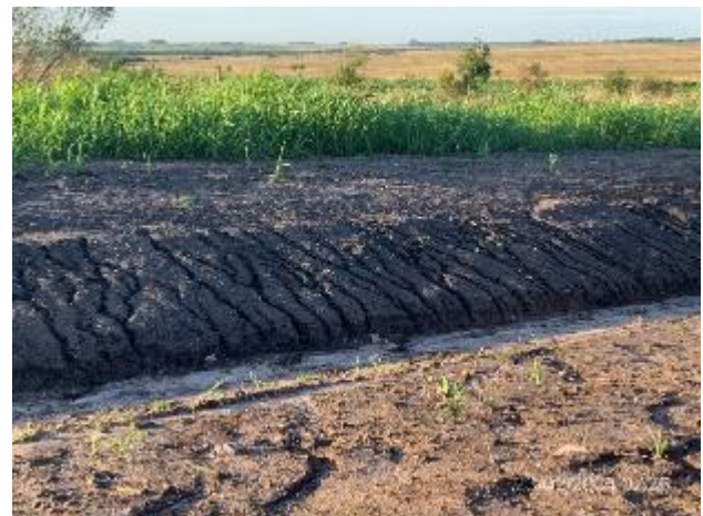
Foto 12.2-4, Ruta 20. Talud y contra talud erosionados. No hay cobertura vegetal.
