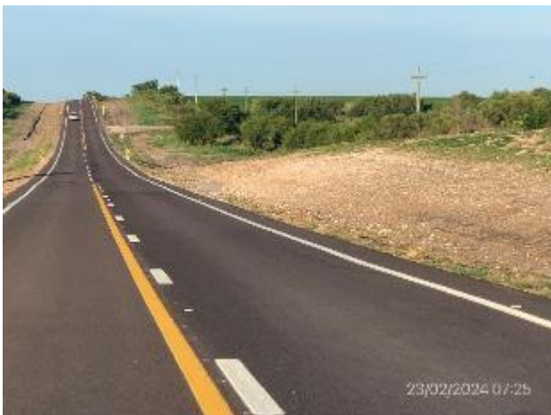
Foto 12.2-3, Ruta 20. Tramo de talud de faja pública sin cobertura vegetal.
