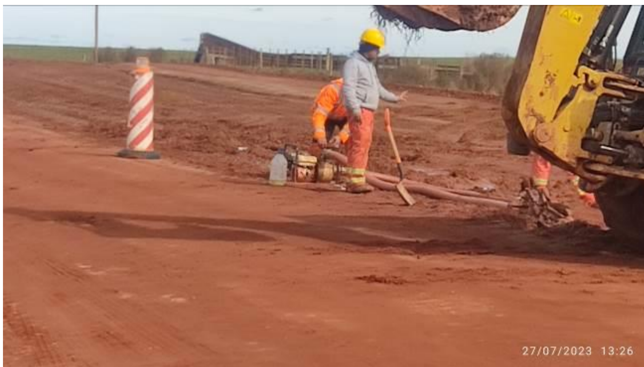
Foto 11.1-1 Tanque de Combustible sin contención.
