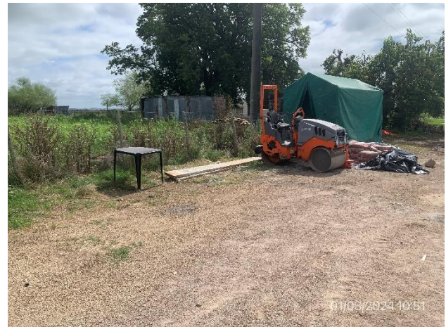
Foto 12.2-10, P07. Existe infraestructura para acopio de residuos pero igualmente hay residuos dispersos.
