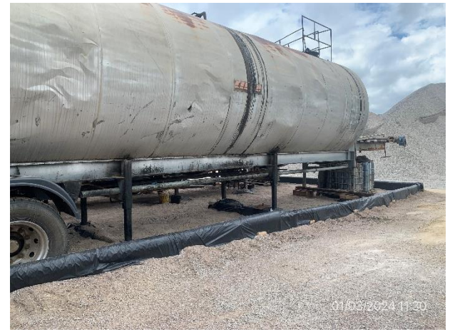
Foto 12.1-4, P04. Planta asfáltica en proceso de ensamble, vallado perimetral correcto de tanque de asfalto.
