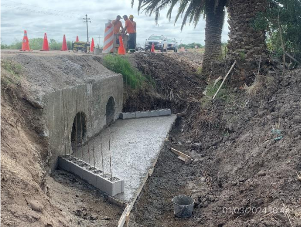
Foto 12.2-7, P05. Frente de obras, piso de alcantarilla en proceso de fraguado. No hay infraestructura para acopio de residuos segregados.
