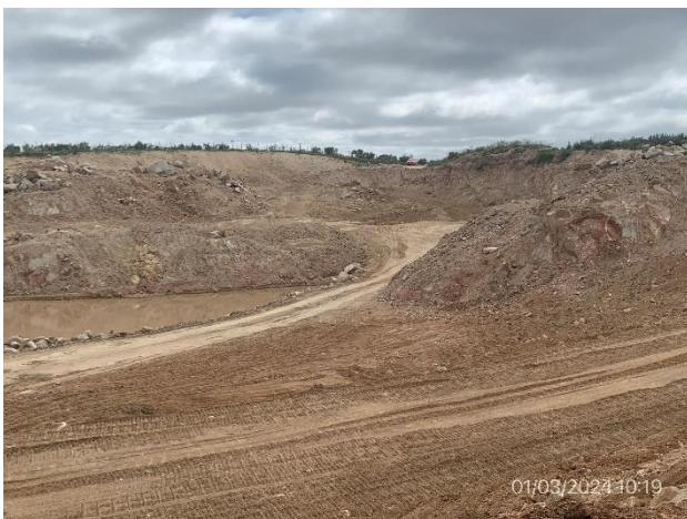
Foto 12.1-11, P03. Carece de servicios de bienestar para operarios, de infraestructura para gestión de residuos y de los elementos para hacer frente a contingencias ambientales.
