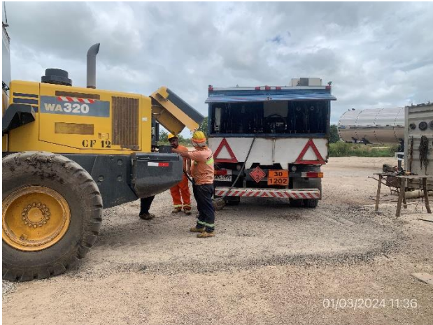
Foto 12.1-7, P04. Obrador, la maniobra de abastecimiento de combustible no es de forma apegada al PGA, no se dispusieron bandejas para prevención de derrames.
