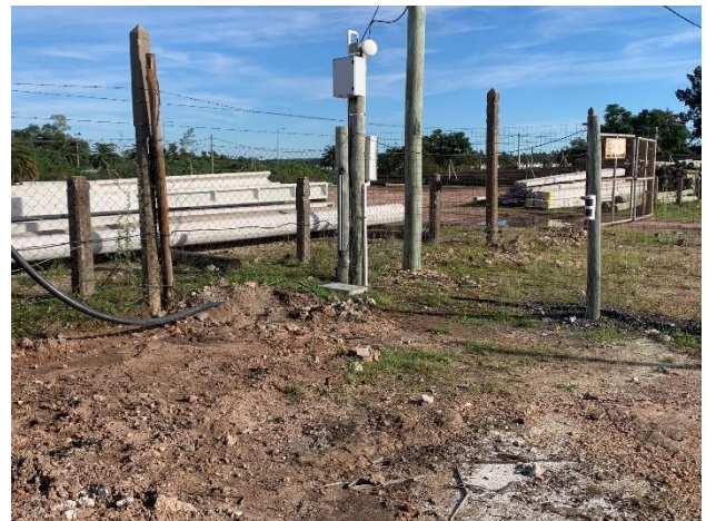
Foto 12.1-4, P02. Instalación de potencia provisoria de UTE a ser retirada.
