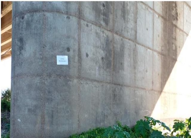
Foto 12.3-3, P01. La empresa colocó delimitación de área inundable.
