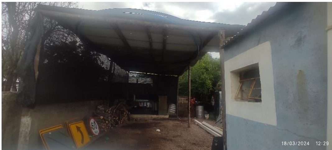
Foto 12.2-1 Derrames de hidrocarburos.
