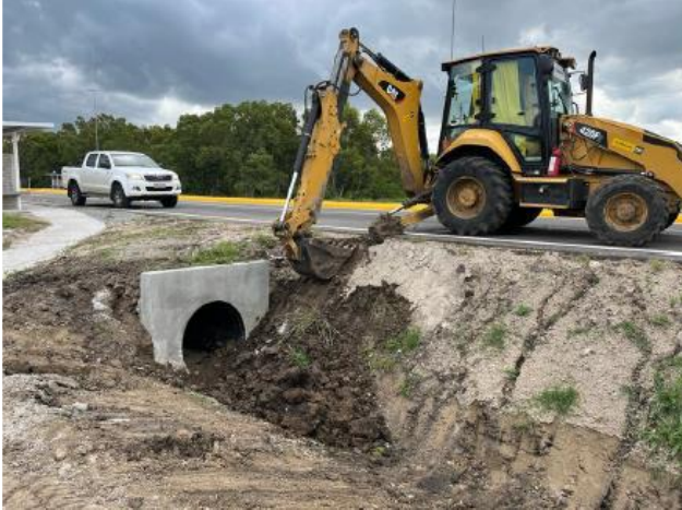
Foto 12.3-1. Corrección de erosión en Pueblo Nuevo. Fotografía del 13/12/2023 proporcionada por la empresa.
