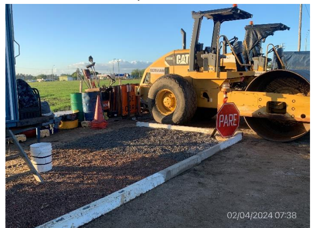
Foto 12.2-6, P03. Campamento provisorio, recinto envallado para acopio de residuos contaminados.
