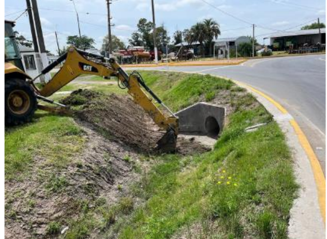
Foto 12.3-2. Corrección de erosión Ruta 11 y Ruta 45. Fotografía del 14/12/2023 proporcionada por la empresa.
