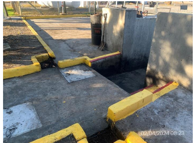
Foto 12.1-6 P04. Obrador, explanada de lavado de camiones con trampa de grasas y aceites.
