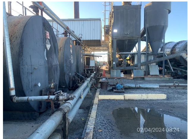
Foto 12.1-4 P04. Planta asfáltica, sector envallado con pavimento impermeable para prevención de derrames.
