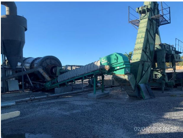
Foto 12.1-3 P04. Planta asfáltica, buenas condiciones de orden y limpieza.
