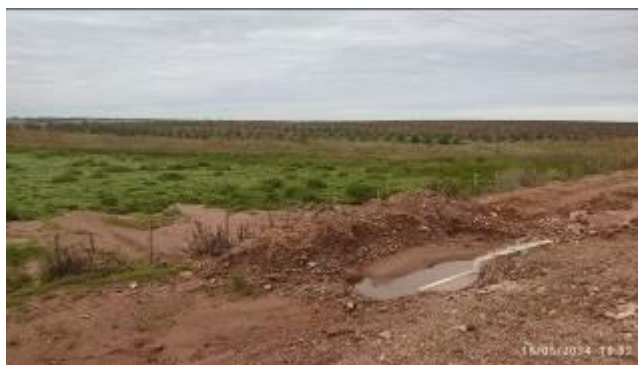
Foto 12.4-1 Material obstruyendo cauce de alcantarilla.
